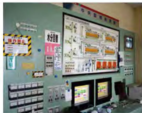
写真8=中央監視制御盤
