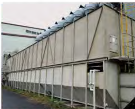
写真7=全量湿化湿式処理装置
