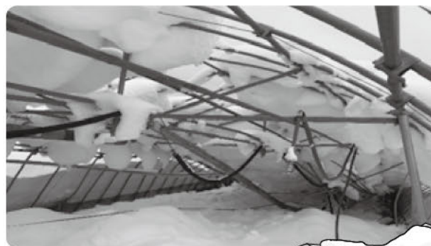
積雪による被害
