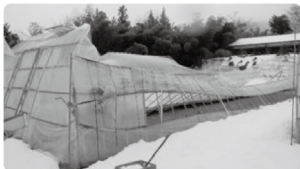
積雪による被害
